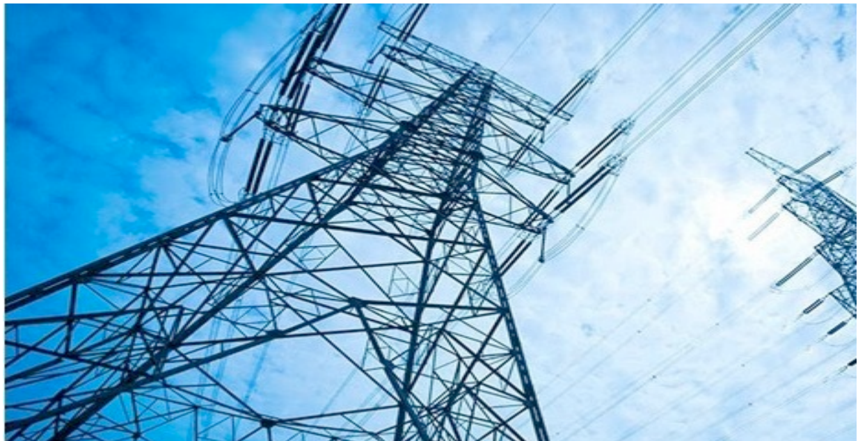
Exemple de ligne de transmission
