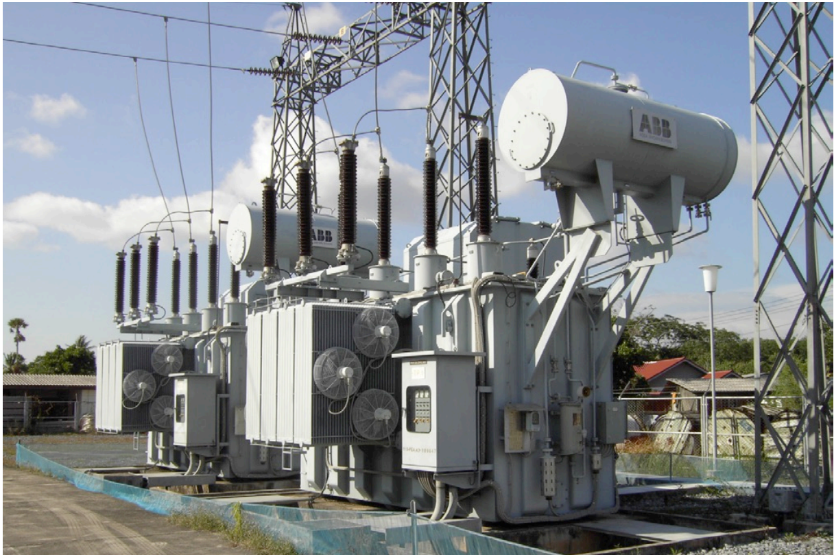
Exemple de sous station
