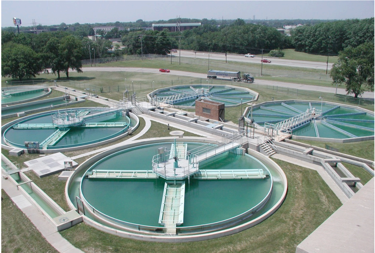
Exemple d'installation des stations d'épuration
